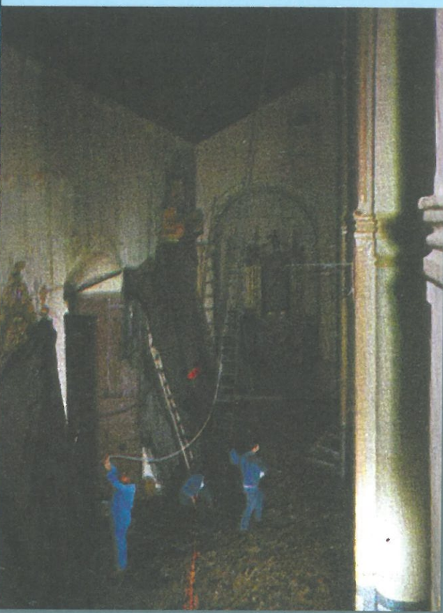
Estado en que quedó el templo tras el incendio. 1982.
