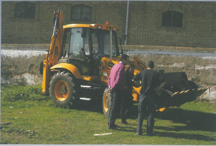
El Ayuntamiento cuenta con una nueva máquina multiusos
