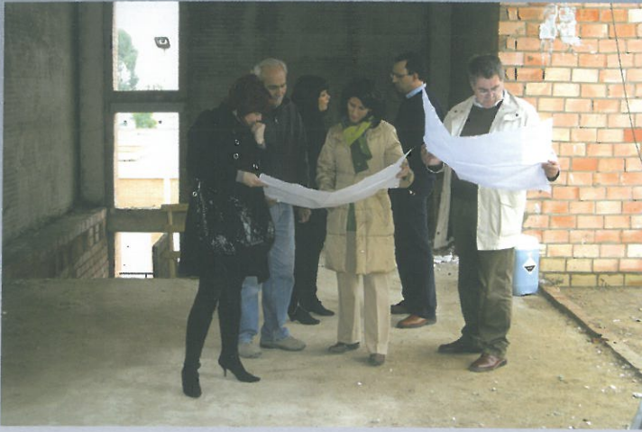
Las obras de la futura Guardería Municipal van a un muy buen ritmo
