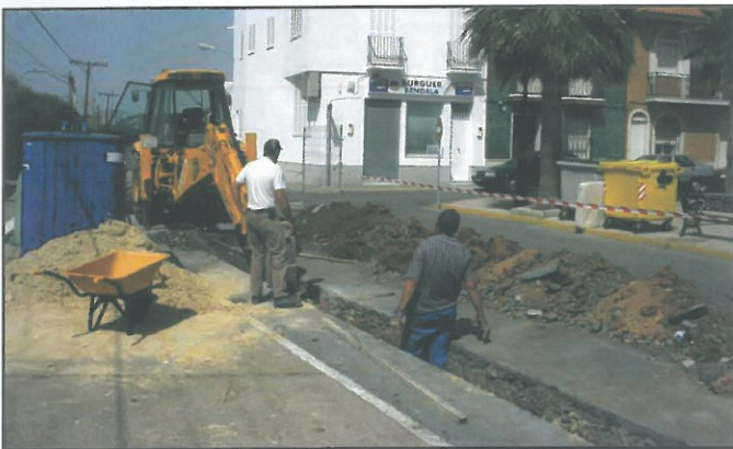
Canalización de las aguas hasta la depuradora a través de la estación de bombeo.
