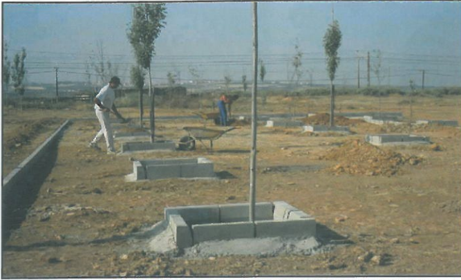
Actualmente se están acometiendo diversas obras en la prolongación del Parque Municipal
