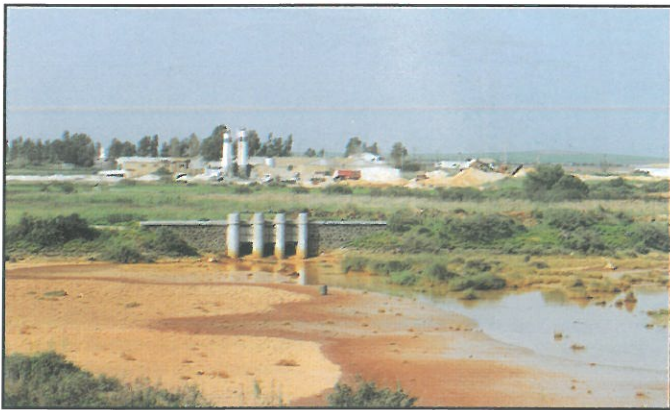
Muro de contención reconstruido y vista de una de las nuevas compuertas
