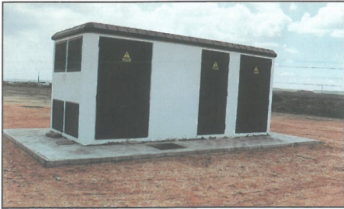
Caseta de instalación eléctrica para la futura iluminación del Parque Municipal
