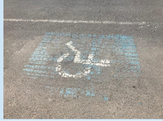
Pintura PMR en mal estado de conservación.
